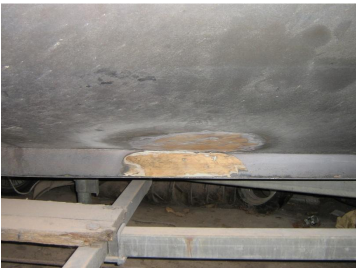
Eine der Schadstellen am Unterwasserschiff
